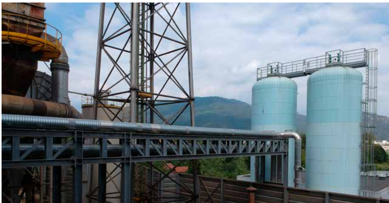
Alfa Acciai: sistema di tubazioni di alimentazione dell'impianto recupero calore dall'acciaieria e serbatoi di accumulo
