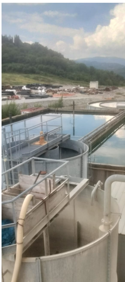
Impianto di depurazione delle acque meteoriche presso il cantiere di Barberino
