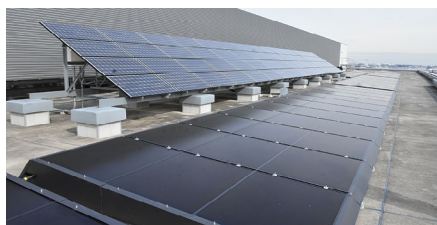
太陽光パネル
