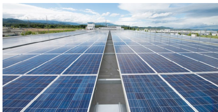
太陽光自家発電設備
