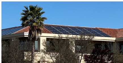
太陽光発電設備
