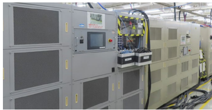
回生電源検査設備
