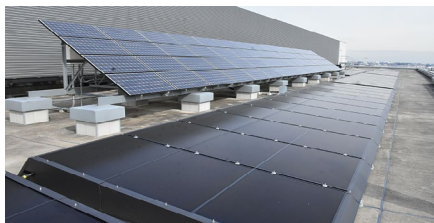
太陽光自家発電設備
