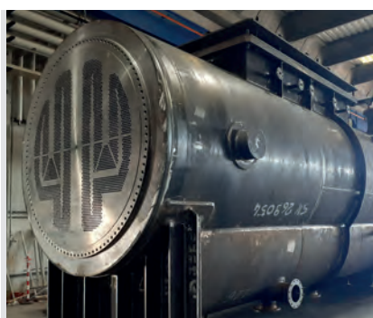
Condensatori di vapore
