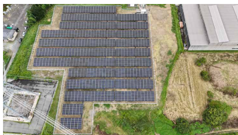
大和ハウス工業 九州工場の敷地内にある太陽光発電設備
