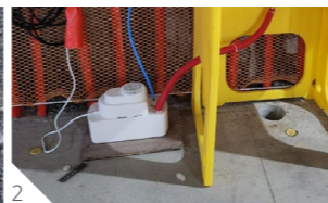
1. 페드레인보드 활용 친환경 오탁수정화시설 2. 폐에어컨펌프 활용 가설소변기 자동배수시스템 운영
