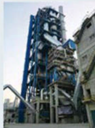
セメントプラント 排熱発電設備
