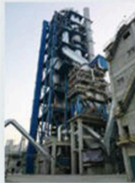
セメントプラント 排熱発電設備
