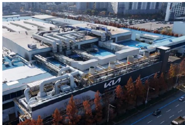
친환경 농축RTO 설치
