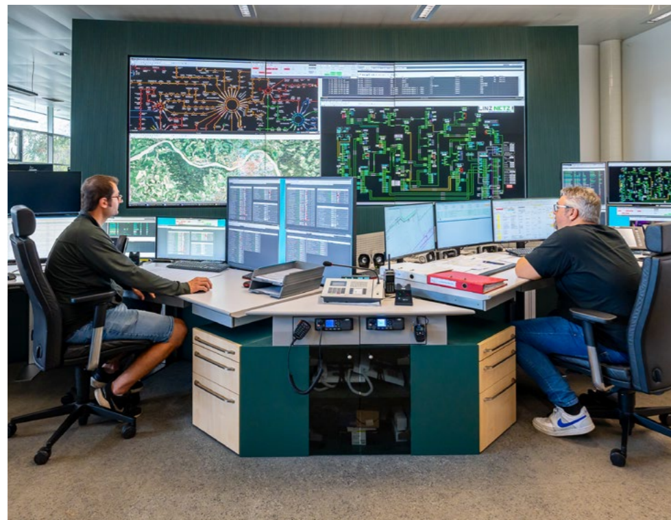
Die Netzleitzentrale der LINZ NETZ GmbH – hier in einer Aufnahme aus 2024 – wurde im Laufe der Jahre immer wieder modernisiert.
