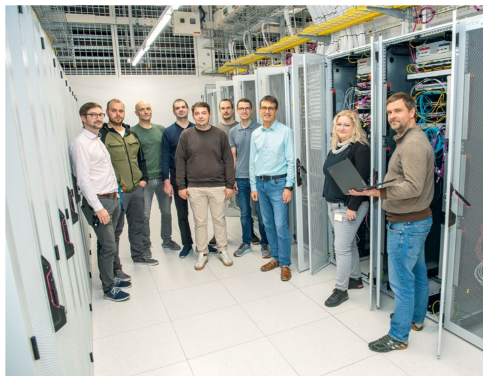
IT- und Data Center 1: Das Projektteam der Bereiche Informations- management, Telekom und LINZ NETZ GmbH
