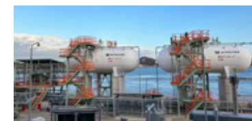
アンモニア供給設備
