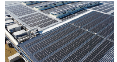
藤沢第二工場に設置された太陽光発電機
