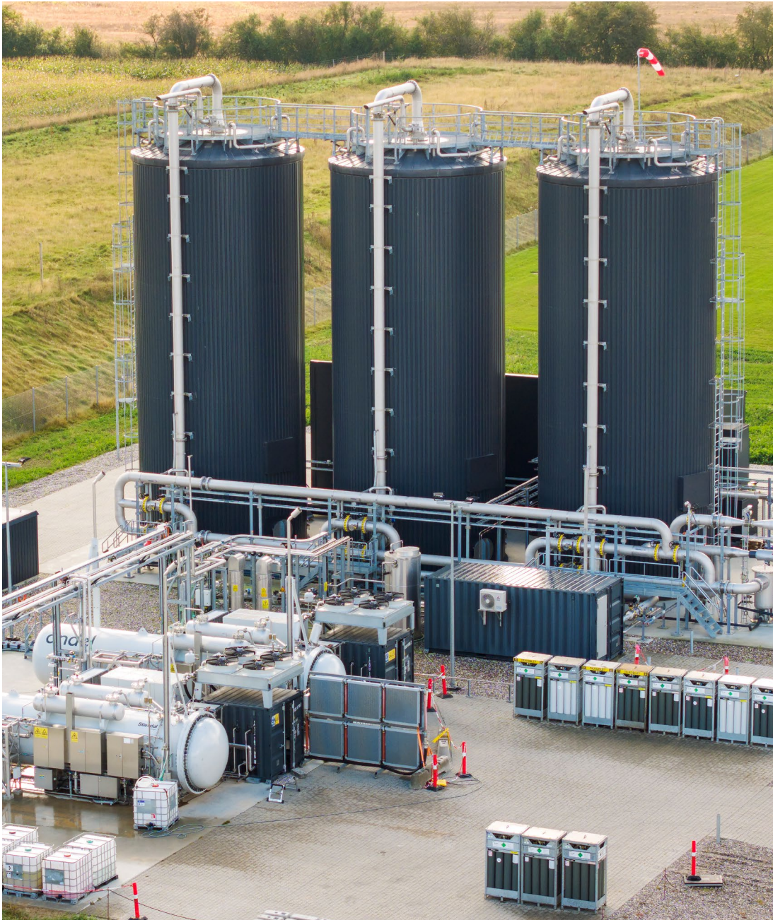
I Andel og Nature Energys fælles Power-to-X-anlæg i Glansager omdannes overskydende strøm fra sol og vind til brint. Brinten bliver sammen med biogen CO 2 til e-metan, der føres ud i naturgasnettet og fortrænger en tilsvarende mængde fossil naturgas.
