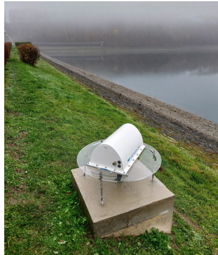
Spezielle ECR-Messinstrumente an mehreren Talsperren des Ruhrverbands gehören zu einem Forschungsvorhaben, das Erkenntnisse zur Tauglichkeit von satellitenunterstützter Stauanlagenüberwachung liefern soll.
