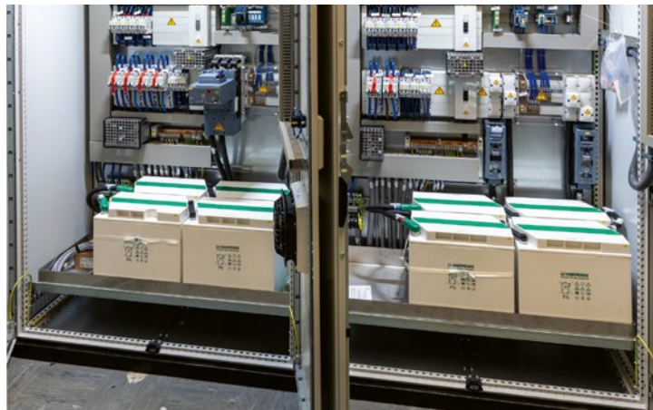
Der Schaltschrank mit zwei redundanten Batterien ist das Herzstück für das neuerdings schwarzsstartfähige Wasserkraftwerk an der Biggetalsperre.
