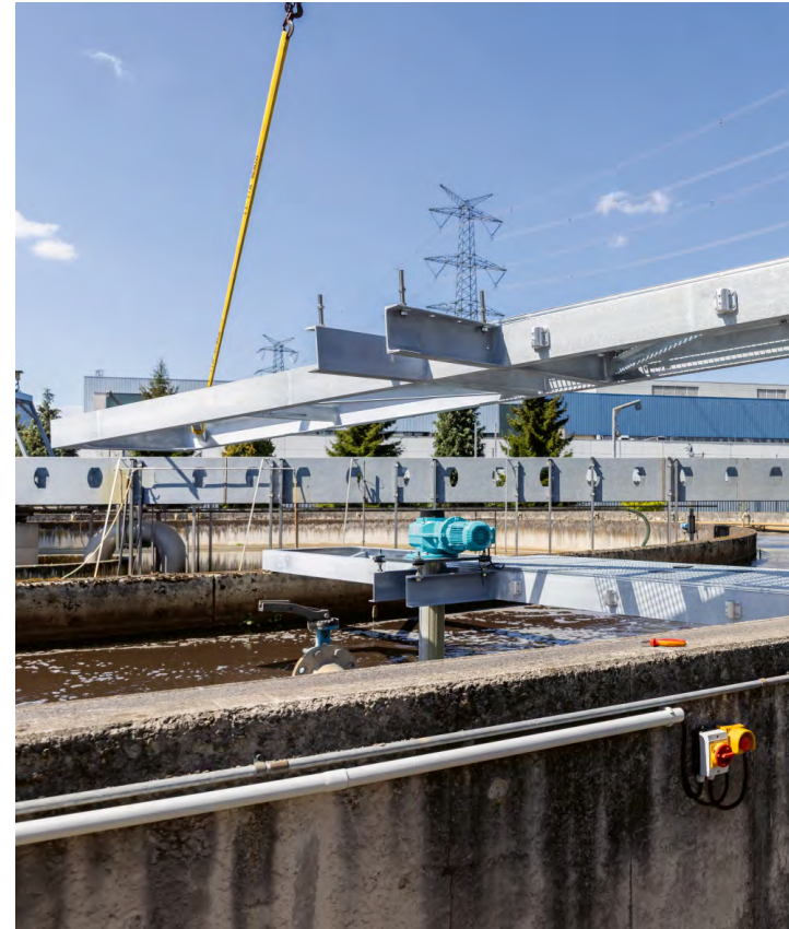
Die Werkskläranlage Hagen-Kabel der insolventen Papierfabrik KPPP betreibt der Ruhrverband seit Juni 2025. Die provisorische Inbetriebnahme der erweiterten Stickstoffelimination erfolgte nach drei Monaten, weitere Umbauten werden folgen.
