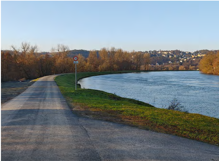
Vernässungen entlang des luftseitigen Dammfußes machten im Jahr 2025 Sanierungsarbeiten am Obergrabendamm des Harkortsees erforderlich.
