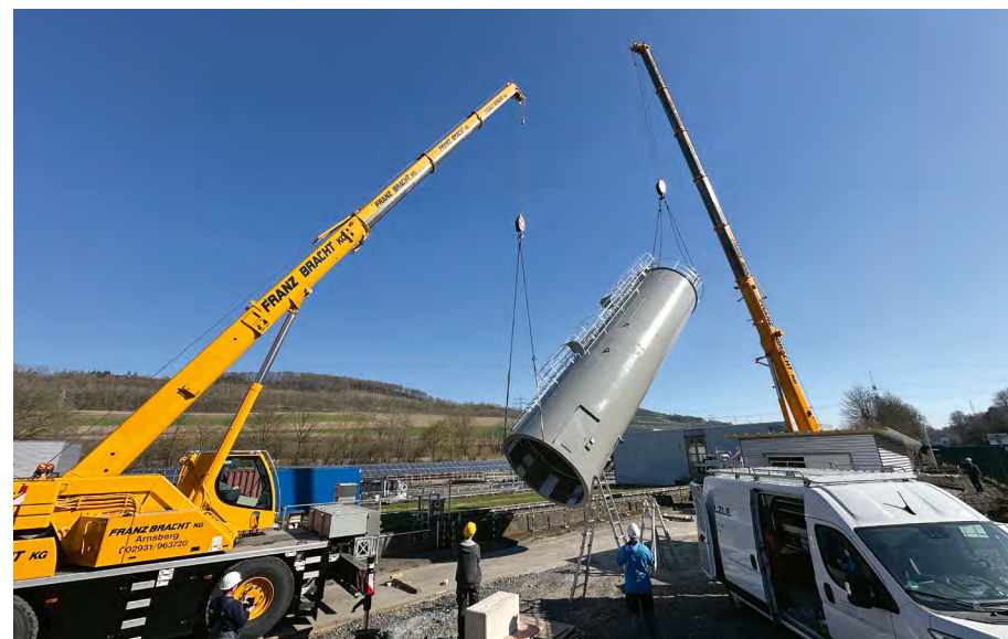
Im April 2025 wurden die Silokörper für die neuen PAK-Dosieranlagen auf den beiden Kläranlagen angeliefert, die Inbetriebnahme erfolgte fristgerecht im Juni.
