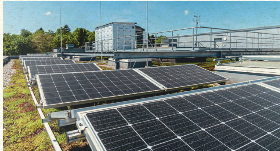
Photovoltaik mit Dachbegrünung am Standort Bruckmühl
