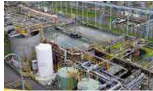
活性汚泥処理施設
