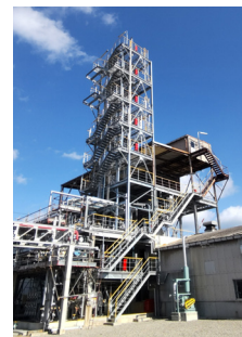
PMMAケミカルリサイクル 実証設備
