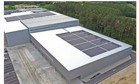
サントリー天然水 北アルプス信濃の森工場 太陽光発電パネル
