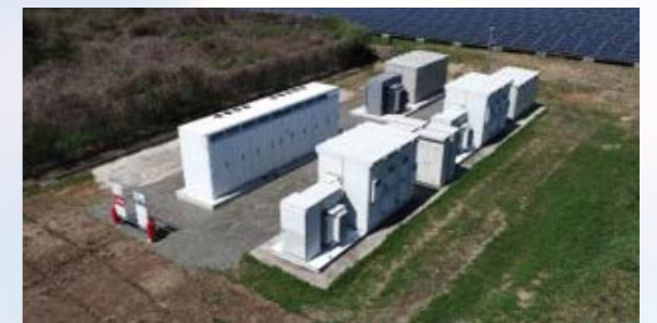
熊本・荒尾メガソーラー発電所に設置した併設型蓄電池
